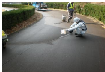
クラック補修
