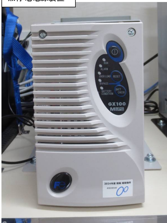
無停電電源装置
