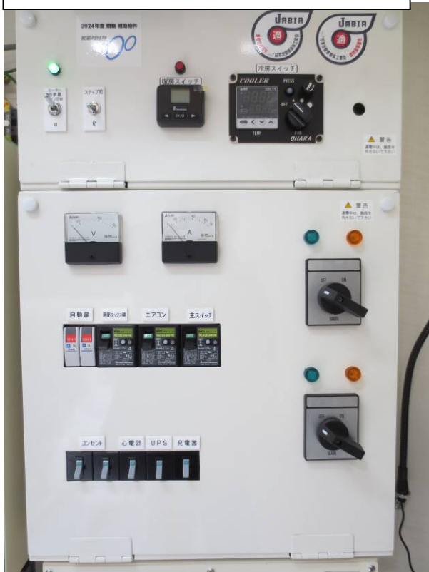
冷房操作部・暖房操作部・電源切替配電盤
