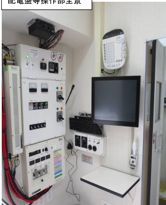
配電盤等操作部全景
