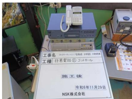
入替機器 (非常電話) 監視塔
