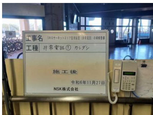
入替機器 (非常電話) 貸出場
