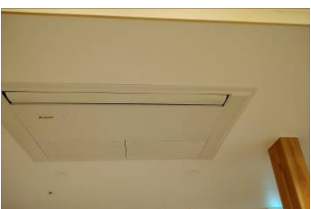
リビングエアコン
