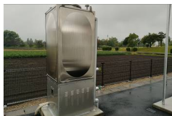
スプリンクラータンク
