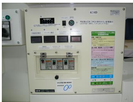
蓄電池配電盤
