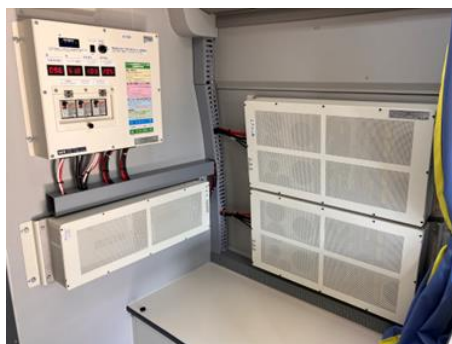
蓄電池システム
