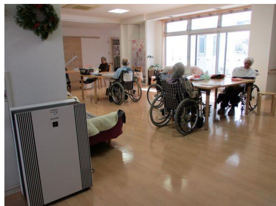
入居者が集うユニットのホールに設置
