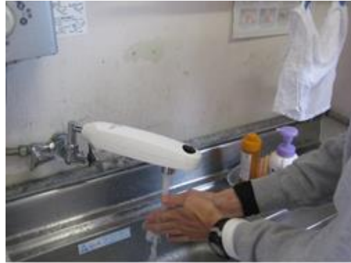
自動水栓（洗面所）
