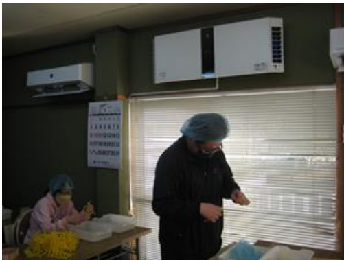
空気清浄機（作業室1）
