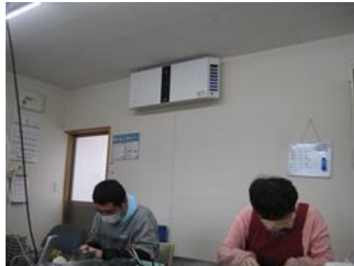
空気清浄機（作業室2）
