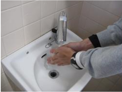
自動水栓（トイレの手洗い）
