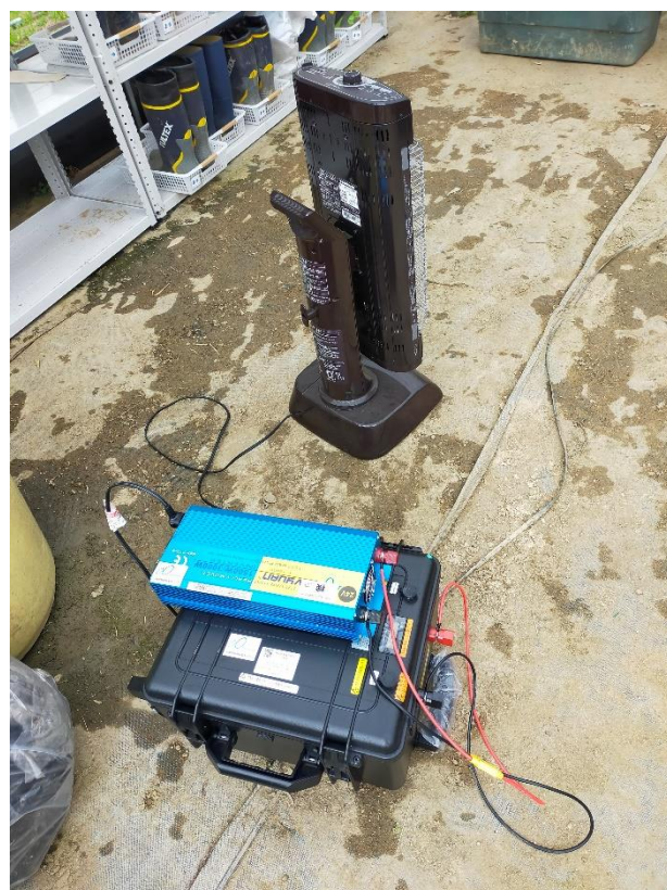
蓄電池を使って暖房器具を稼働させている
