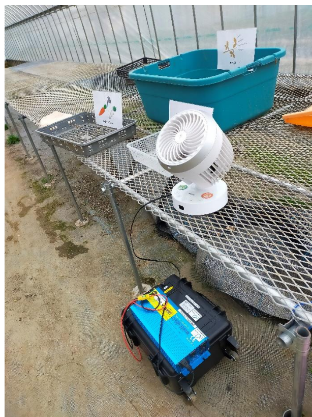
蓄電池を使って、サーキュレーターを稼働させている
