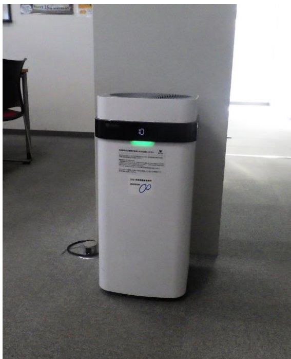
・ボランティアコーナーに設置した空気清浄機
