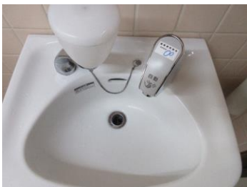
共同トイレに自動水栓機
