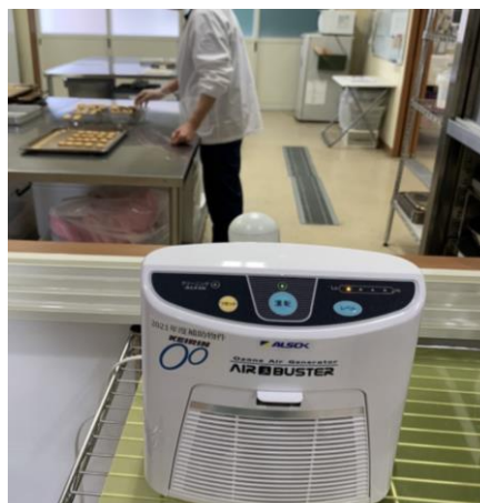
食品棟に設置
