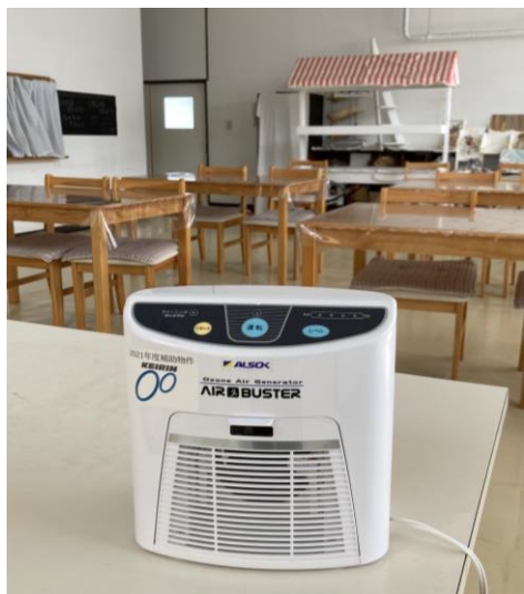
旧棟多目的ホールに設置
