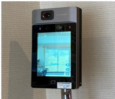
検温モニタ設置
