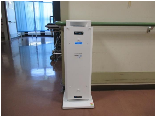
空気清浄機 特養施設2F 食堂に設置稼働中（2台）
