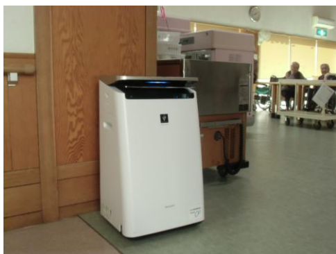
正面玄関に設置②
