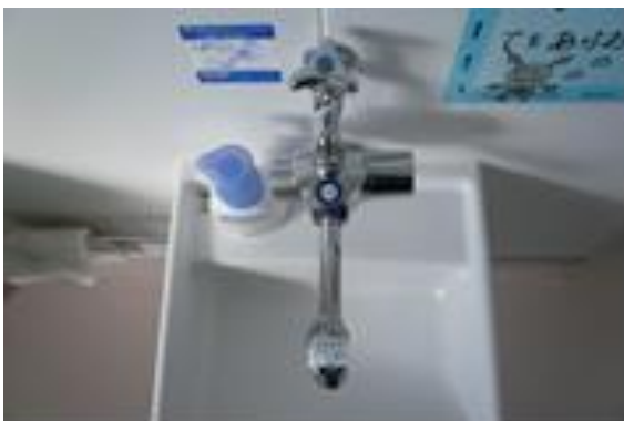
手洗い場に設置した自動水栓
