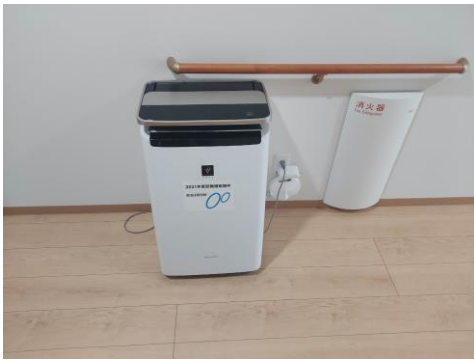
空気清浄機 (施設廊下設置)
