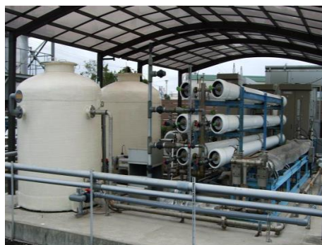
エネルギー回収システム概観
