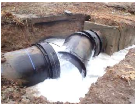
図 地震災害(SP可とう管の漏水状況)
