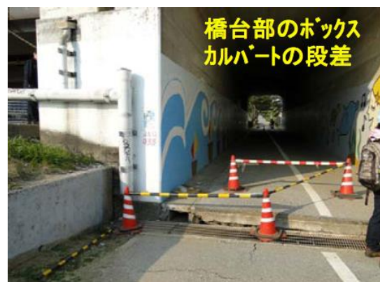
図 地震災害(液状化による段差発生状況)
