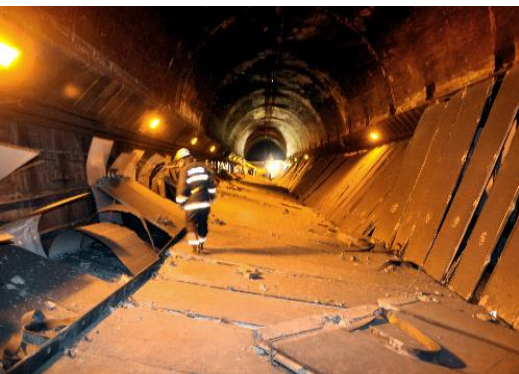
図 中央自動車道(笹子トンネル天井版落下事故状況)
