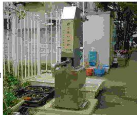
図 防災井戸の設置例(東京都荒川区尾久小学校、防災井戸)
