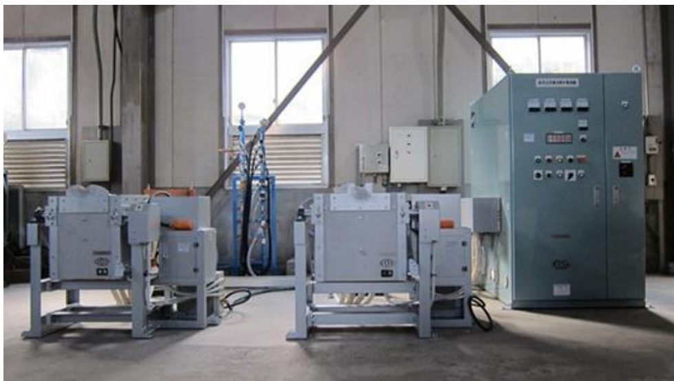
高周波誘導溶解炉全体図
