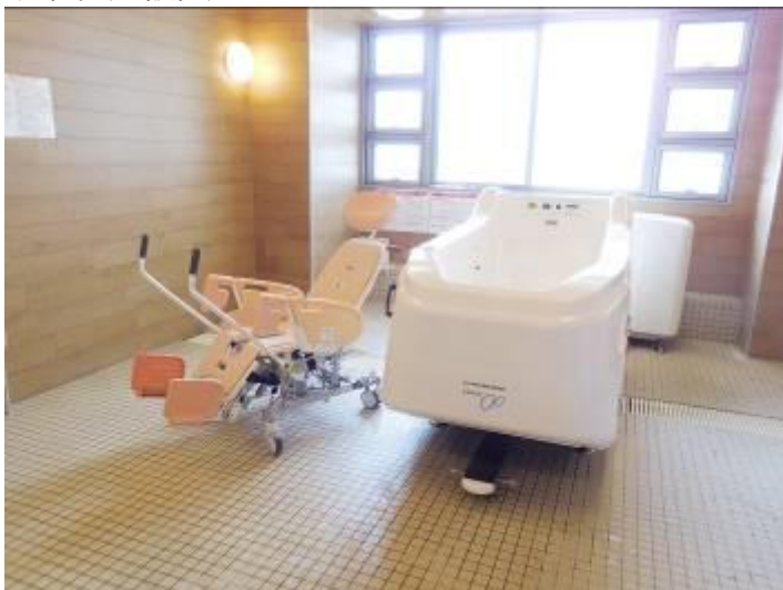
車椅子浴 (3F設置)
