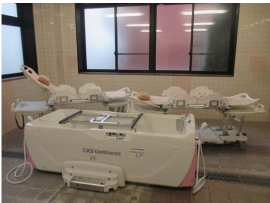
更新した特殊浴槽一式の写真
