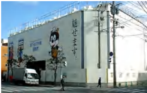
写真 5.2.2-3 防音ハウス例 2
