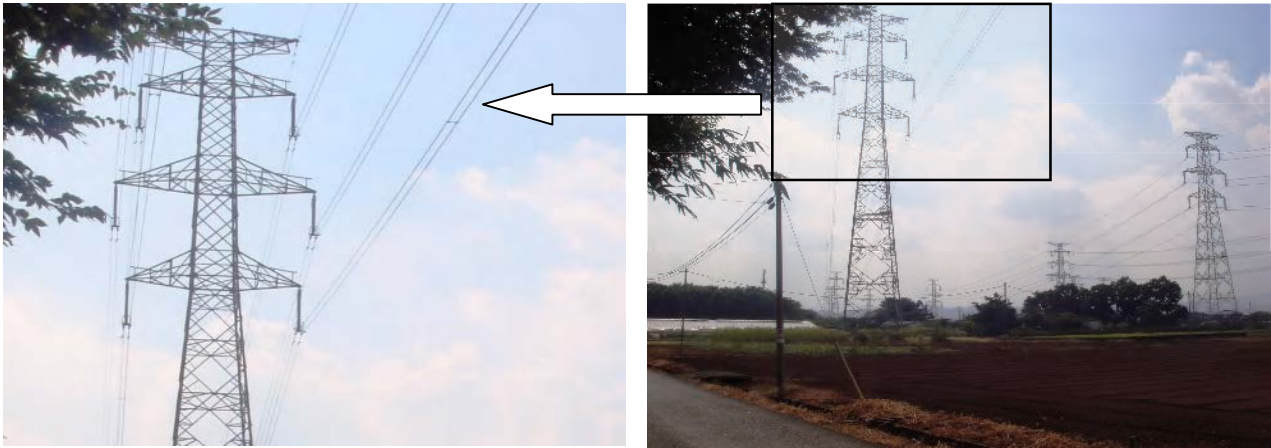
図 3.2-2 複数の導体で、1本の送電線を形成する多導体送電例
