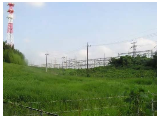
図 2.2-3 新京葉変電所
