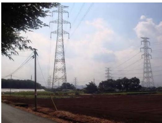
図 2.2-9 新所沢～中東京変電所間 架空送電線
