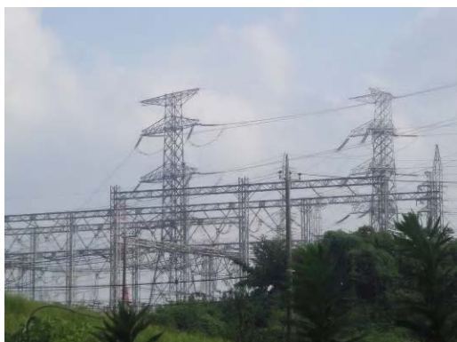
図 2.2-4 新京葉変電所
