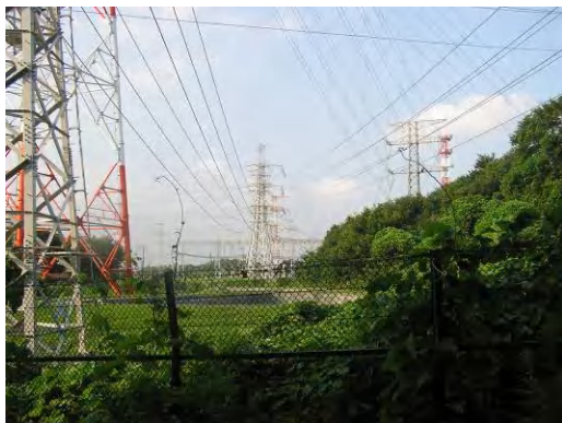
図 2.2-2 新京葉変電所
