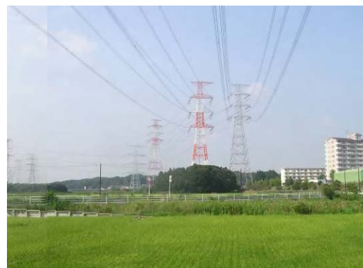
図 2.2-5 新京葉変電所からの架空送電線
