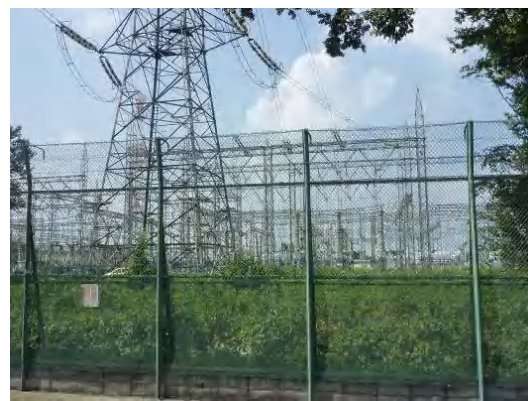
図 2.2-8 新所沢変電所
