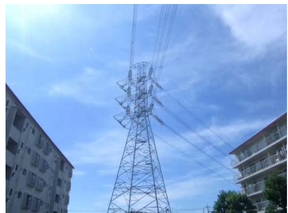
図 2.2-14 集合住宅内架空送電線
