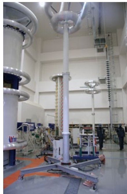
雷のような高電圧・電流を発生させる試験装置。 絶縁保護具や電子部品の絶縁性能の評価などに使用する
