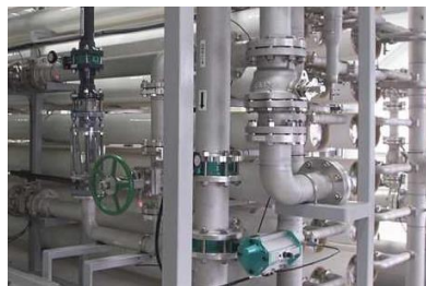
水の効率運用のための水再生回収装置の例 (RO膜装置)
