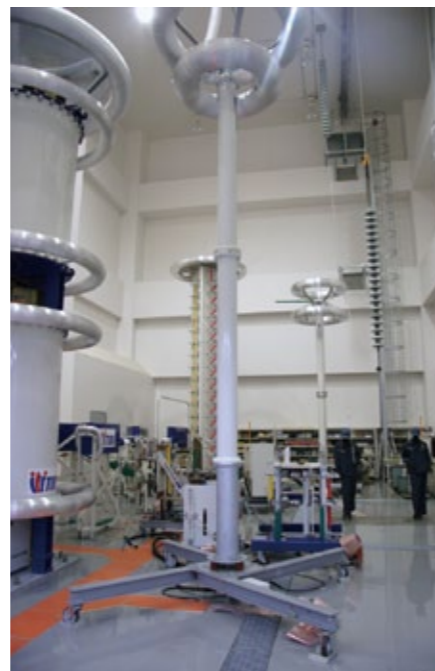
雷のような高電圧・電流を発生させる試験装置。 絶縁保護具や電子部品の絶縁性能の評価などに使用する
